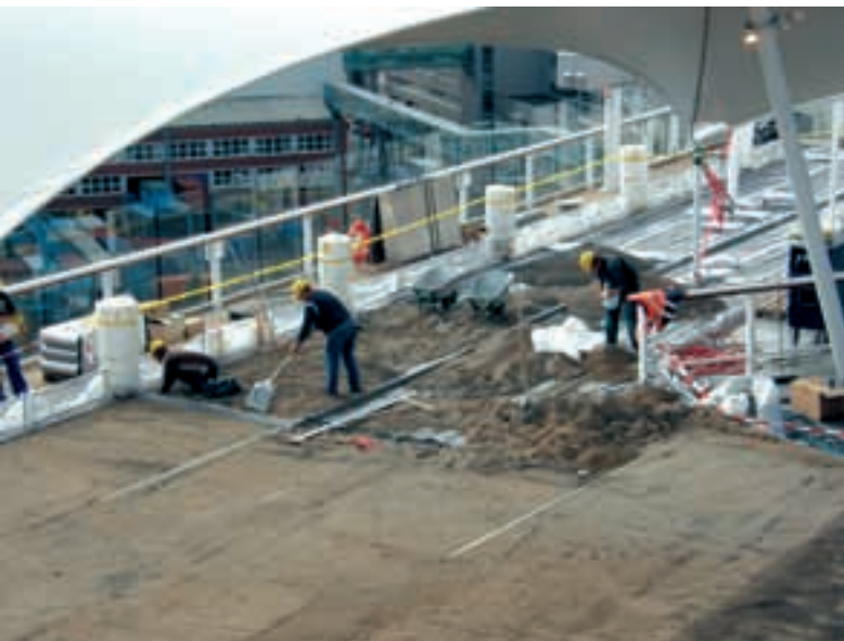
Bei der Arbeit an Deck: Gerade bringen Mitarbeiter des GaLaBau-Unternehmens Borchers GmbH aus Surwold ein Sondersubstrat aus. Es eignet sich für alle Klimazonen, hat eine spezielle Körnung, ist extra leicht, bietet hohe Wasserspeicher-Eigenschaften und hat dennoch eine gute Durchlässigkeit und ein ausreichendes Luftporenvolumen.
